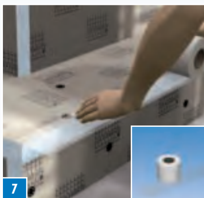
7 Reforçar todas as juntas dos elementos e transições com tecido de reforço em fibra de vidro ARM-100 SK ...
