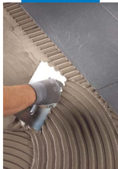
Espalhamento do adesivo em pavimento com espátula de dente arredondada com raio de 9 mm
