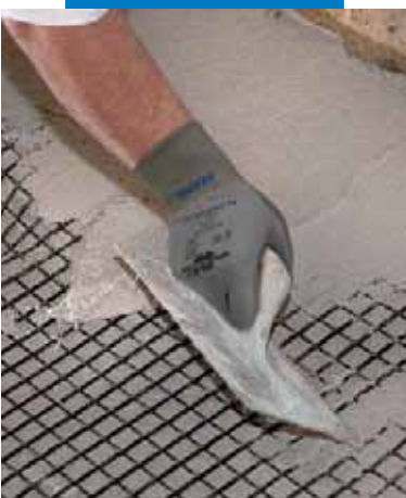
Posa del secondo strato a spatola di Planitop HDM Restauro all'estradosso di una volta in modo da coprire in maniera omogenea la rete Mapegrid G 220
