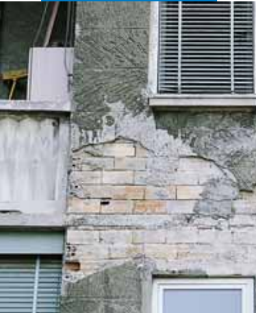
Edifício degradado que necessita de uma intervenção
