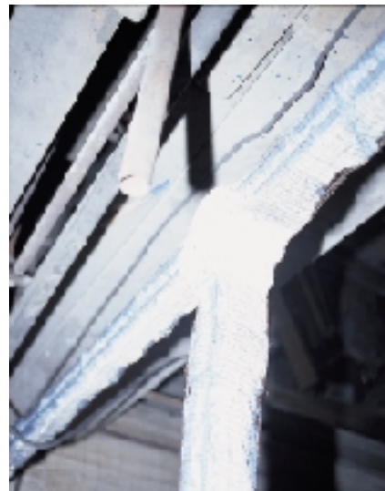
Estrutura em betão degradado
