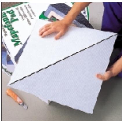
Corte de MAPEFONIC PAD: cortar o tecido colocado do avesso dos quadrados de MAPEFONIC PAD, praticando uma incisão no estrato betuminoso (foto 1) e posteriormente quebrar os quadrados, dobrando-os ao longo da incisão (foto 2)
