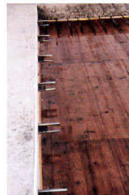
Connessione impalcato-trave con connettori Staifix nello Stadio del Manchester United
